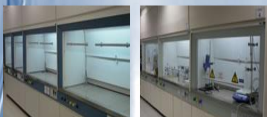
Capelas de exaustão
