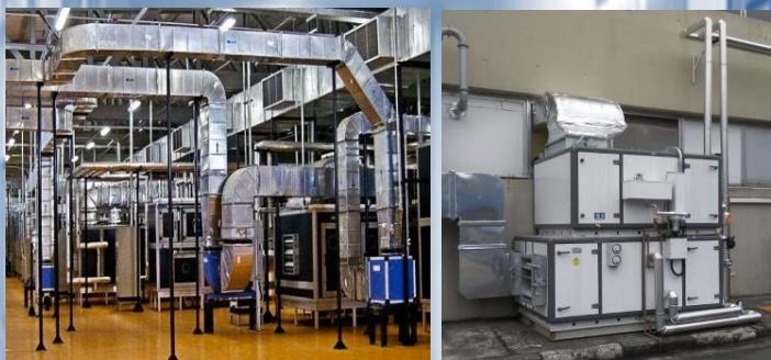
Sistema de tratamento de ar com filtragem absoluta e exaustão, captação de pós e controle de umidade.
