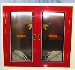
Nicho para extintor
